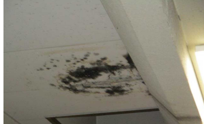
図 9:天井からの雨漏り
