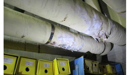
図 10:配管の老朽化
