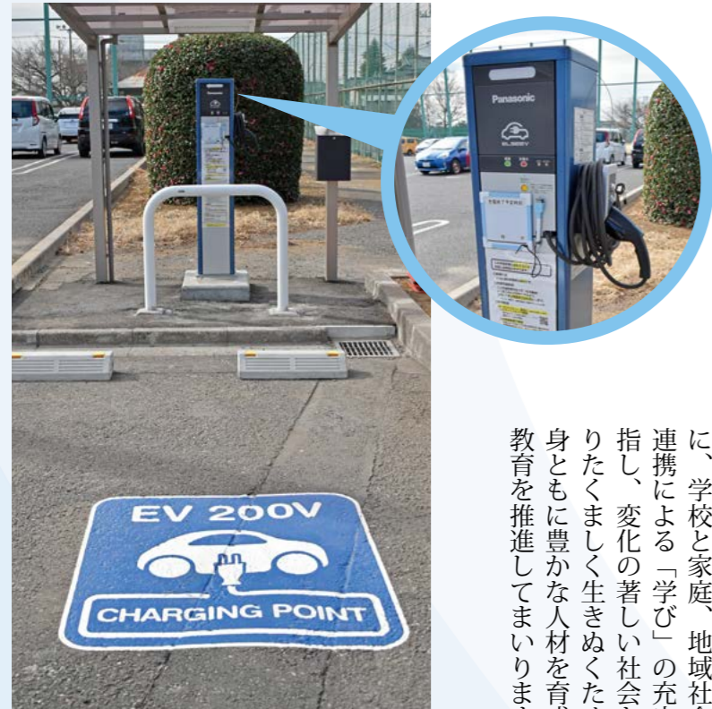
電気自動車等普通充電設備 (保健福祉総合センターに設置)
