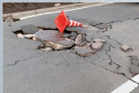
▲道路破損の様子
