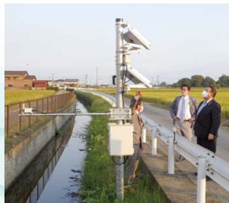
■河川等監視システムの視察
