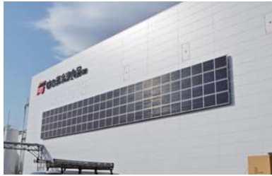
▲4月から本稼働した新工場には 太陽光パネルも設置されています
