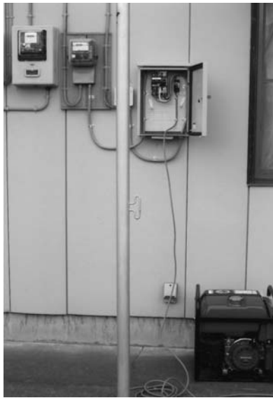
地域公民館設置の非常用電源システム
