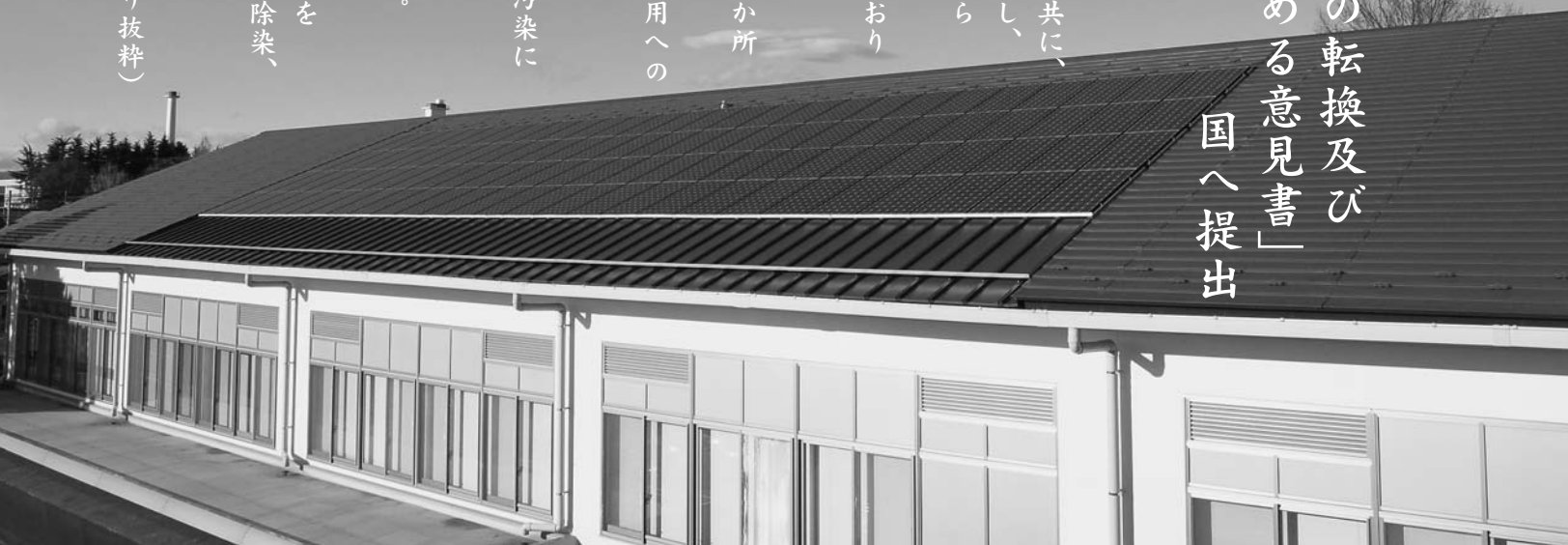
自然エネルギー政策の更なる推進を（太陽光発電システム）
