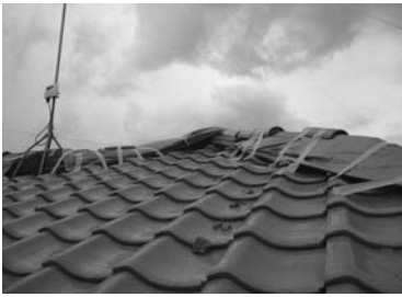
町でも屋根の損壊など 住家の被害がありました
