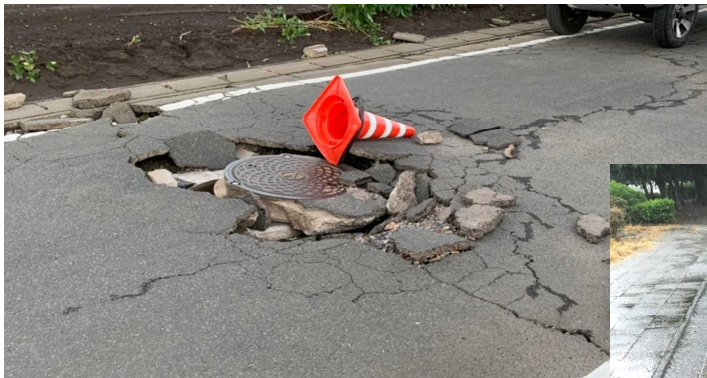
道路破損状況
