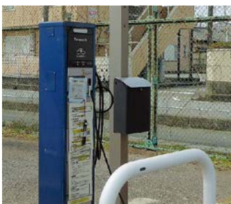
電気自動車充電設備
