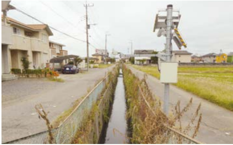
改修工事が待たれる七ヶ村用水路
