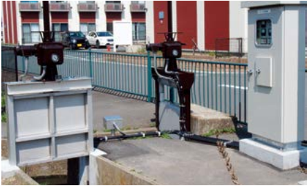
七ヶ村用水路自動門
